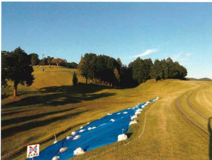
●レディースティー左のシート部が法面崩落個所。
